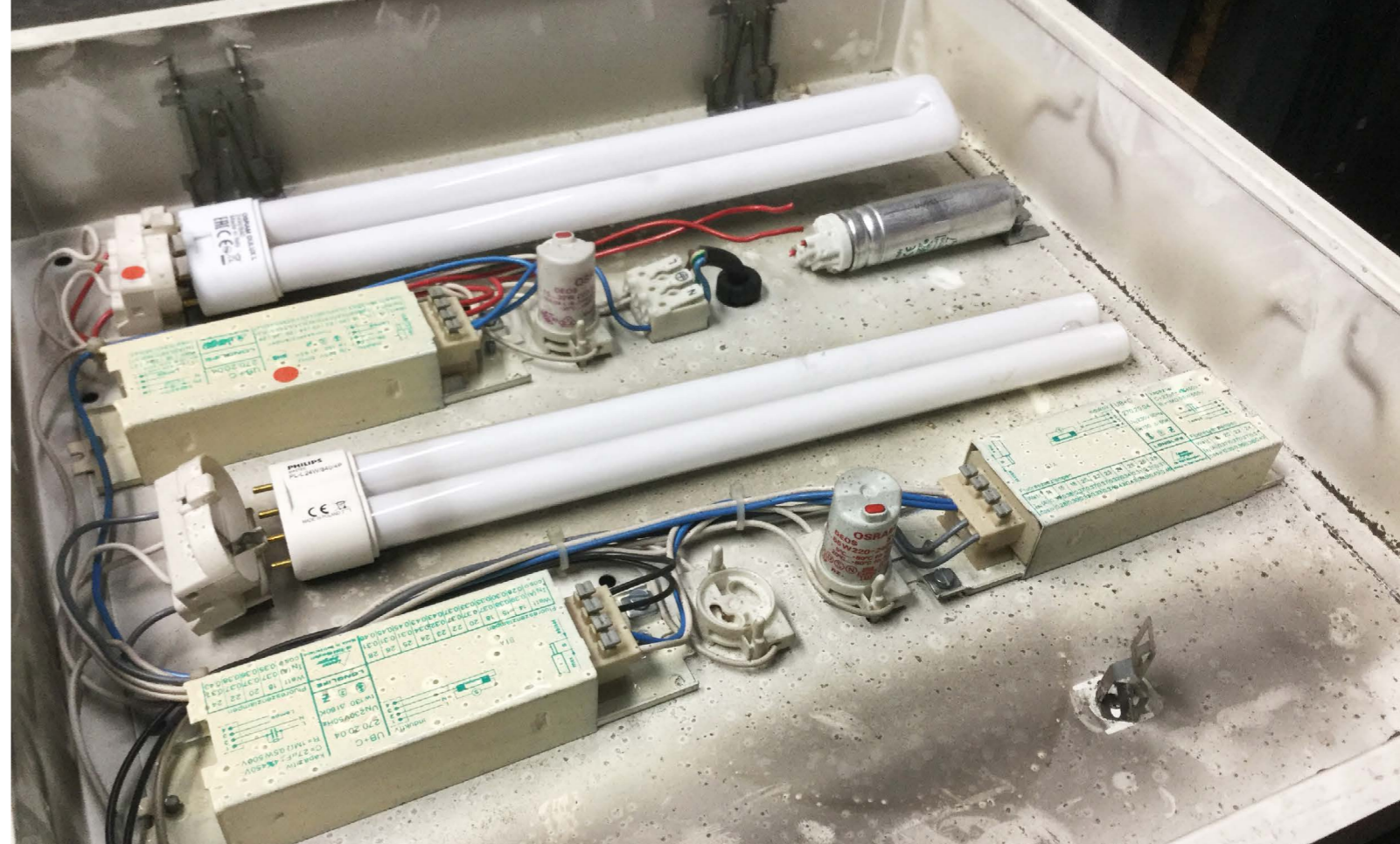
Photo 1: Dans ce luminaire carré, le ballast est constitué de trois parties inductives et d'un condensateur.
