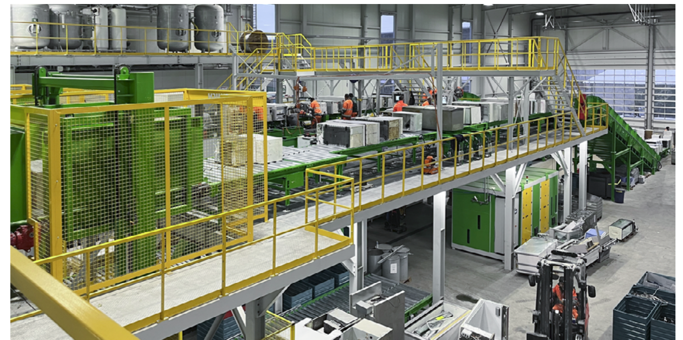
Erdwich-Kühlgeräte-Recyclinganlage der Immark AG. Mitte: Oberes Anlagendeck mit Absaugstationen, links: Geräteaufgabe in die zweite Verarbeitungsstufe, im Hintergrund die N2-Erzeugungsanlage.
