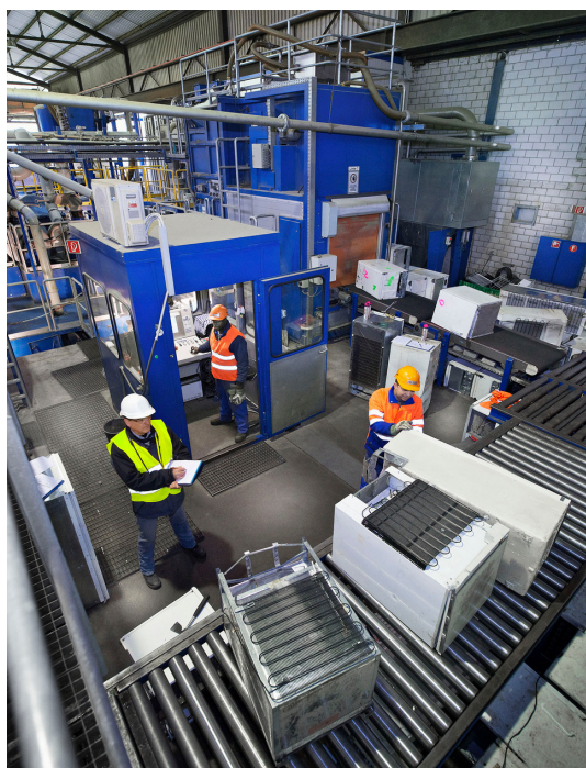
Vue sur une installation de traitement de réfrigérateurs
